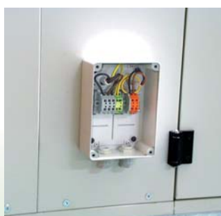
instalacja elektryczna zakończona puszką
